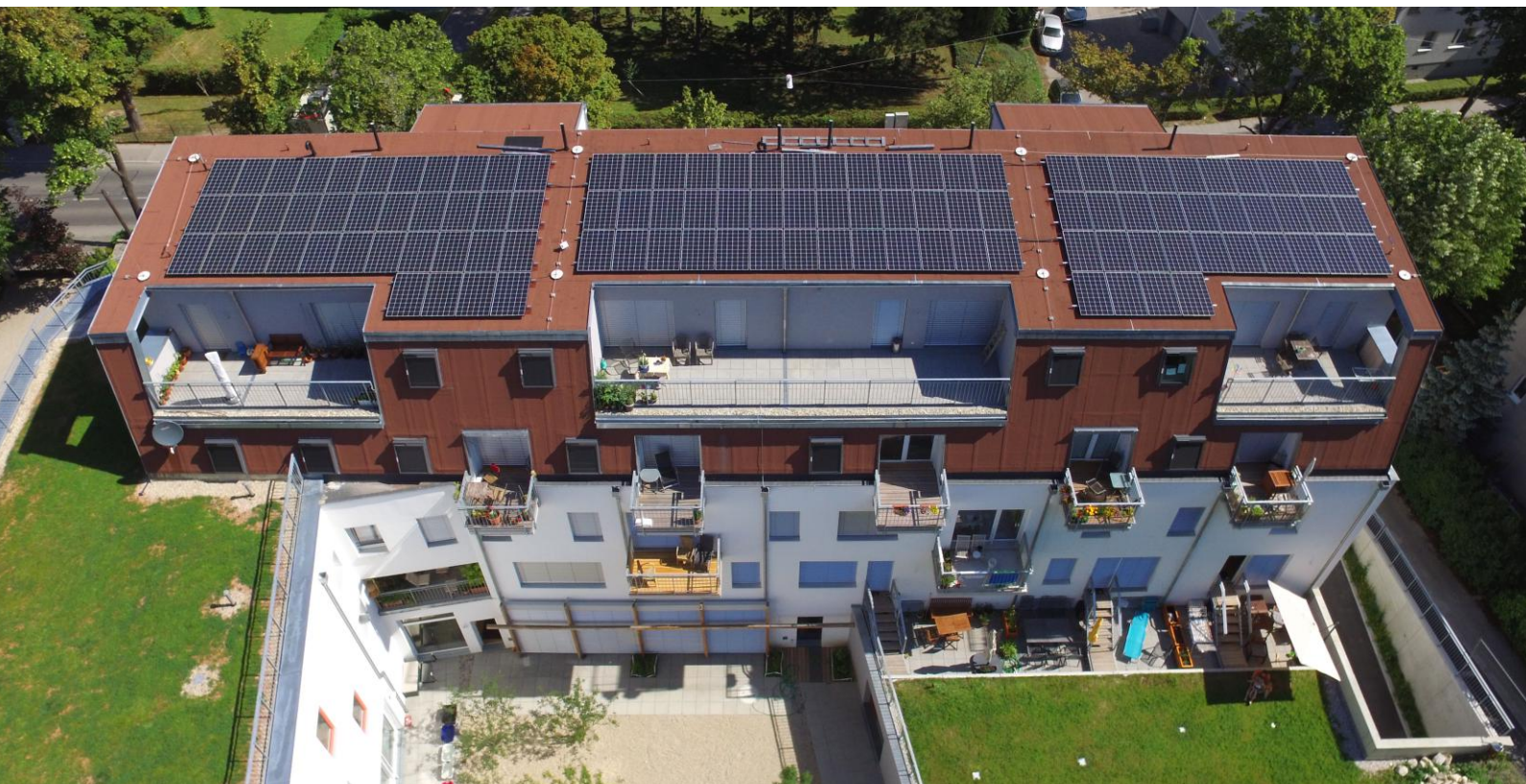
Unsere Photovoltaikanlage mit 31kW Spitzenleistung deckt einen Teil unseres Stromverbrauchs.
